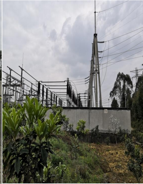
福盛变电站扩展区现状
